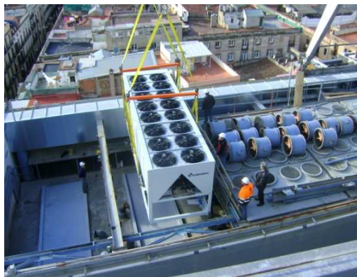
Instal·lacions de les plantes refredadores de la coberta del GT Liceu
